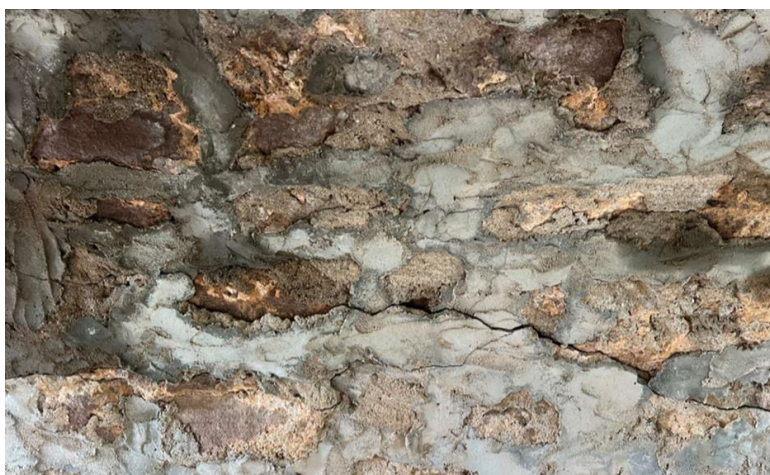
Figure 9 : Infiltration au sein de l'ouvrage (source : PCM GC&OA)
