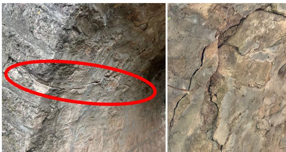
Figure 10 : Fissures constatées sur l'ouvrage (source : PCM GC&OA)
