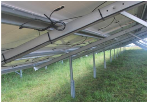
Figure 32 : Câbles protégés et fixés pour éviter tout accident (source Inn'Ovin)
