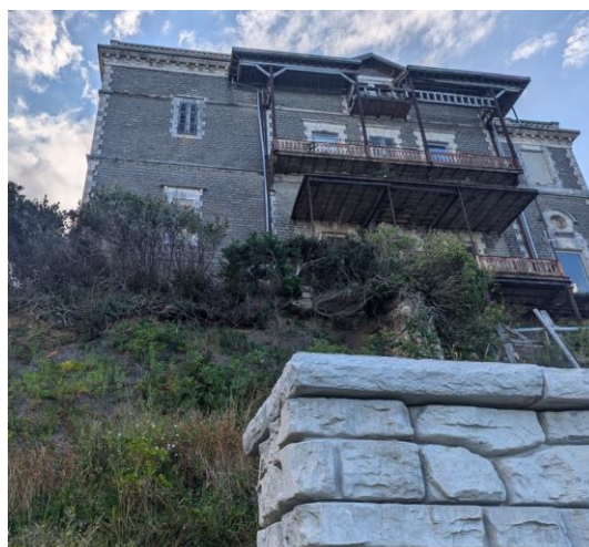
Glissement de terrain et mur de soutènement en contre-bas du château à l'ouest
