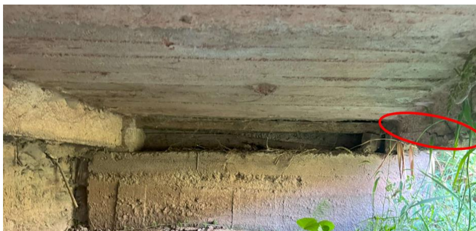
Figure 8 : Défauts présents sur la partie en béton de l'ouvrage – extrait du rapport d'inspection détaillée de BEMS
