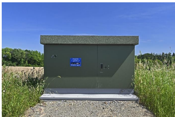
Exemple de poste électrique (PDL et/ou PTR) peint en vert
