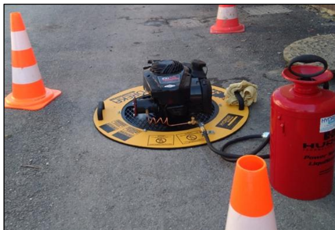
Figure 30: Exemple d'installation pour les tests à la fumée
