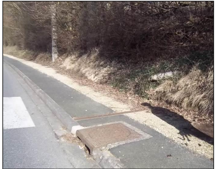
Figure 45 : Dispositifs de recueil des « résurgences » d'eaux au niveau de la Rue de Beauregard
