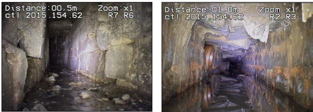
Figure 5 : Pierres instable et affaissement de voûte (Dalot Rue Léonard Bourcier)
