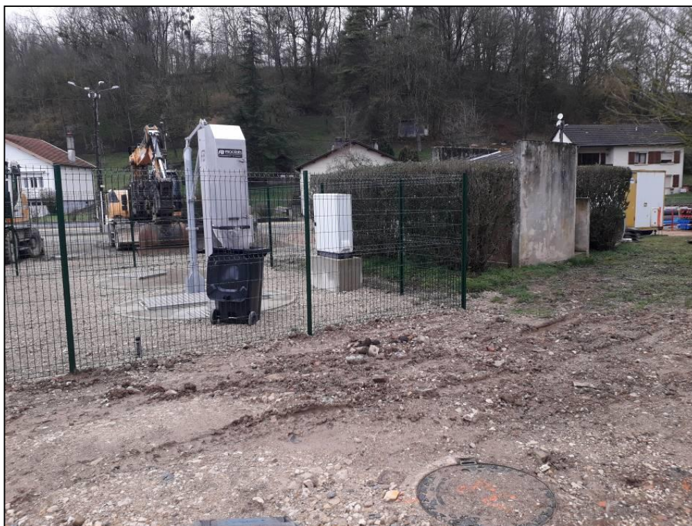
Figure 35 : Poste de pompage général Place du Champ de Foire
