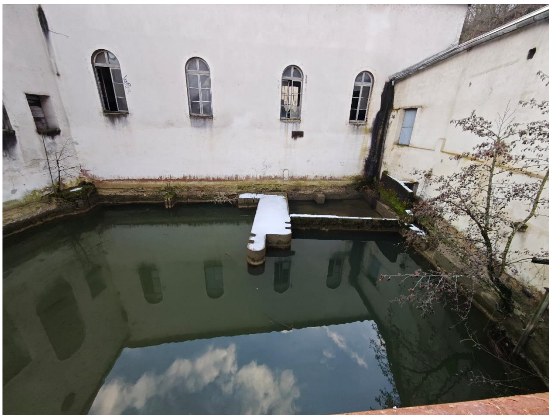
Vue 10 : Le début du canal de fuite, le local technique au fond
