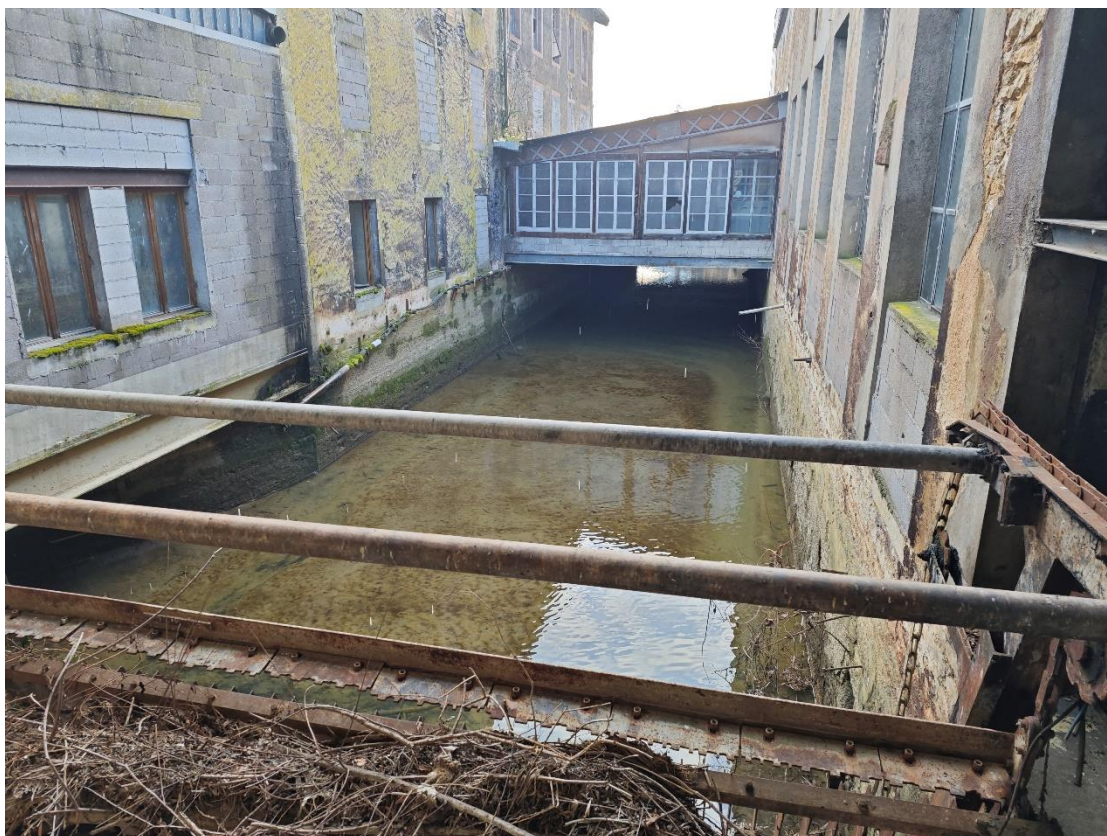
Vue 8 : vue depuis le local technique de la centrale, le dégrilleur au premier plan
