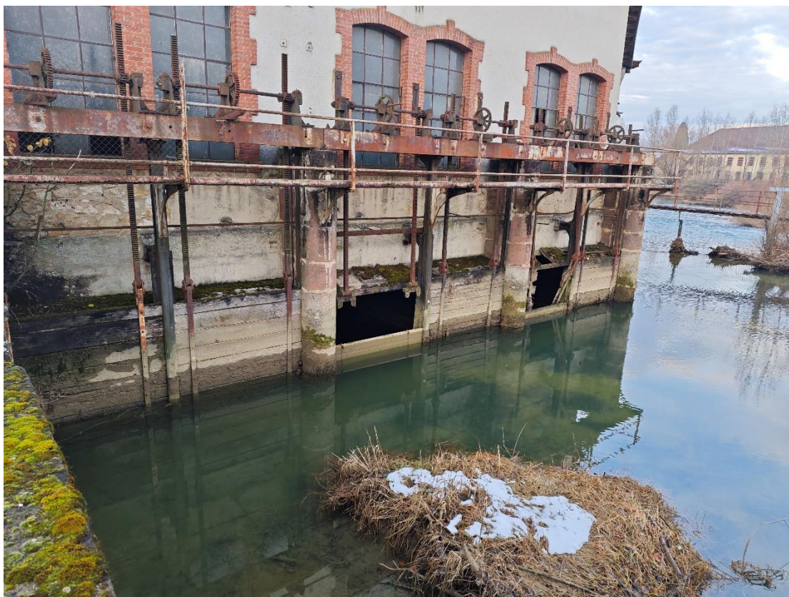
Vue 6 : Les vannes et leurs mécanismes de commande hors-service
