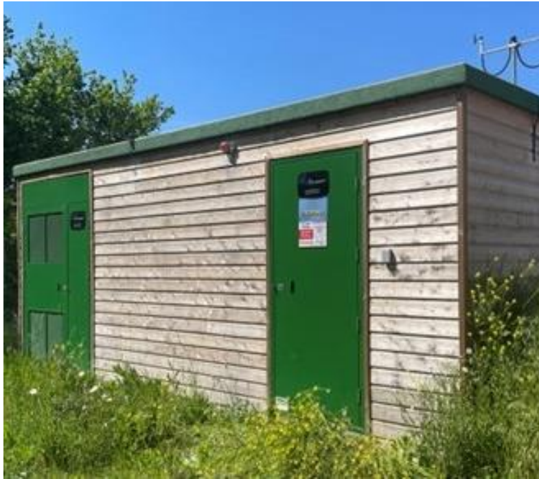
Photo 2 : Exemple de poste de livraison
