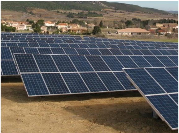
CENTRALE AU SOL THEZAN-DES-CORBIERES
