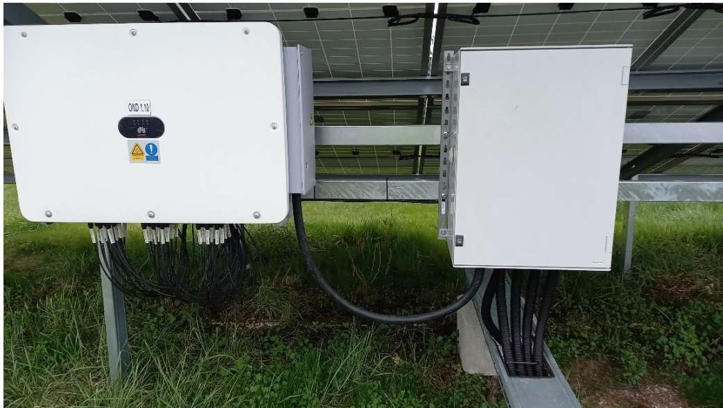
Photo 1 : Exemple d'un onduleur
