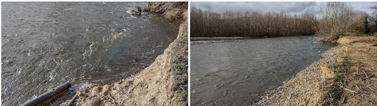
Fig. 6 : Photographies de la canalisation cassée au droit de la rive droite. Source : SME
