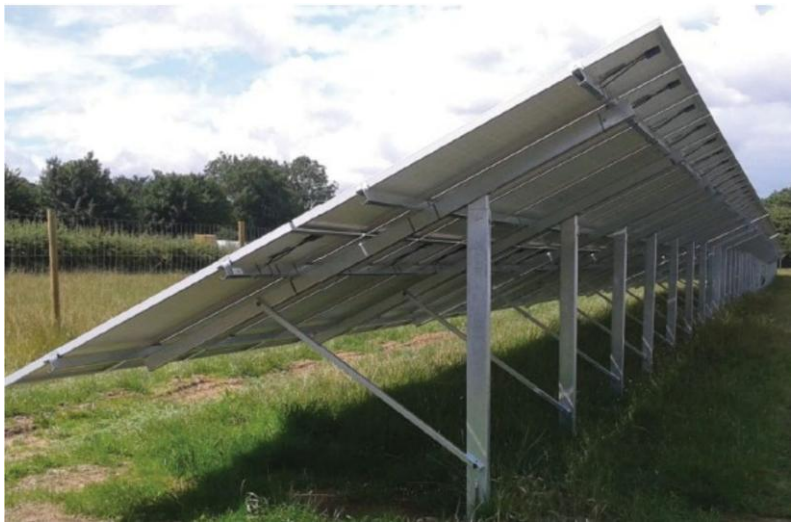
Figure 7 : Illustration des structures photovoltaïques (Source : ESCOFI)
