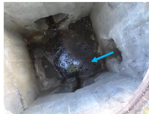
Exutoire de la déverse
