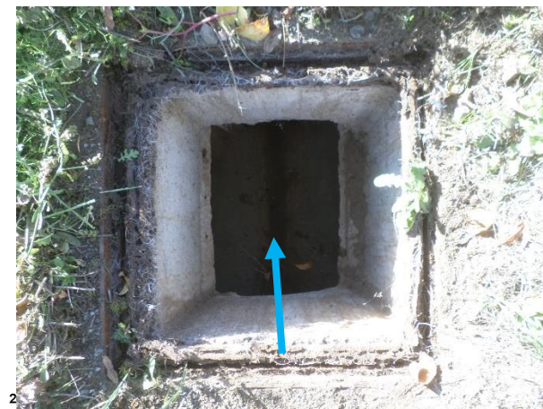
Exutoire de la déverse
