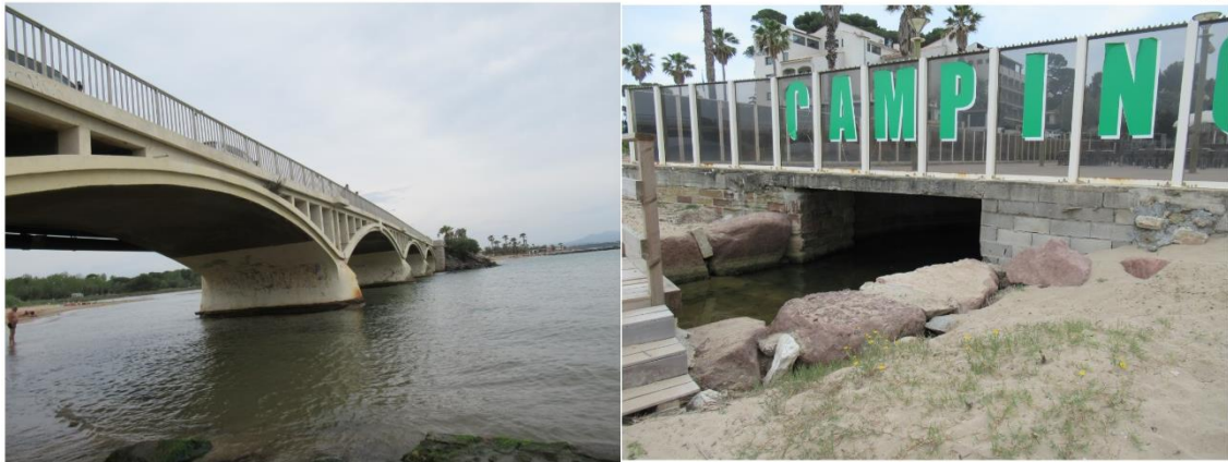
Figure 31. Pont de la Galiote (non favorable) et tunnel (favorable)
