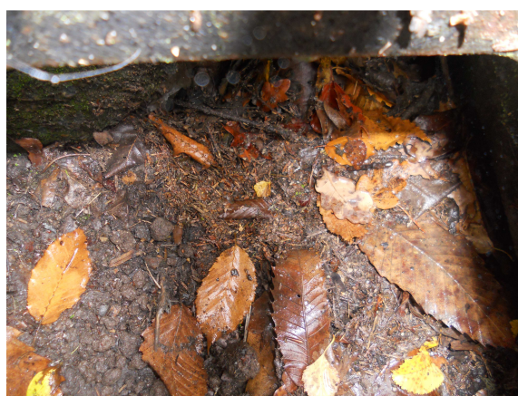
Grille encrassée chemin rural n°156
