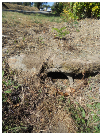
Exutoire bouché VC216
