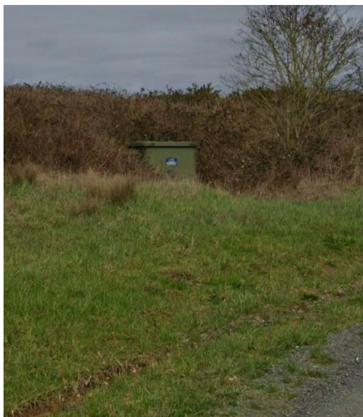
Poste électrique à proximité immédiat du site
