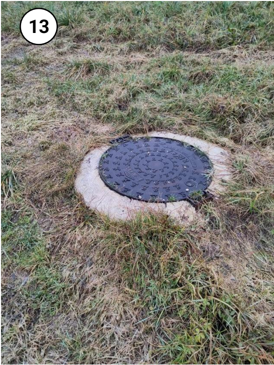
Regards pour canalisations eaux usées et pluviales
