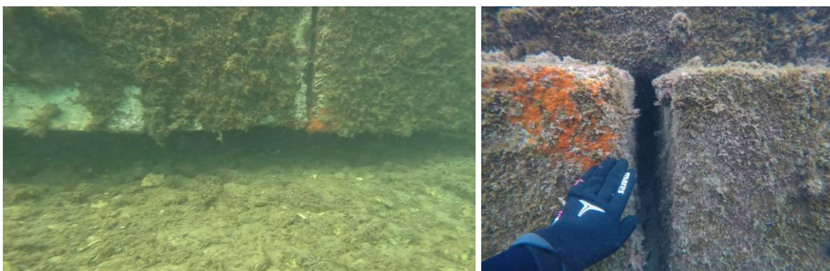
Figure 7 : Léger affouillement sous le 1 er bloc (gauche) et blocs en partie immergée (ETMF)
