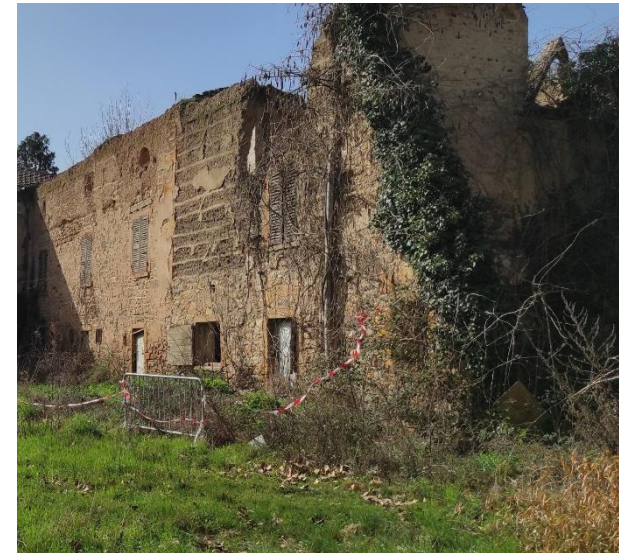
Bâtiment ruiné secteur B
