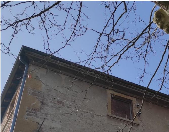
Maison principale – corniche en couronnement à reconstituer
