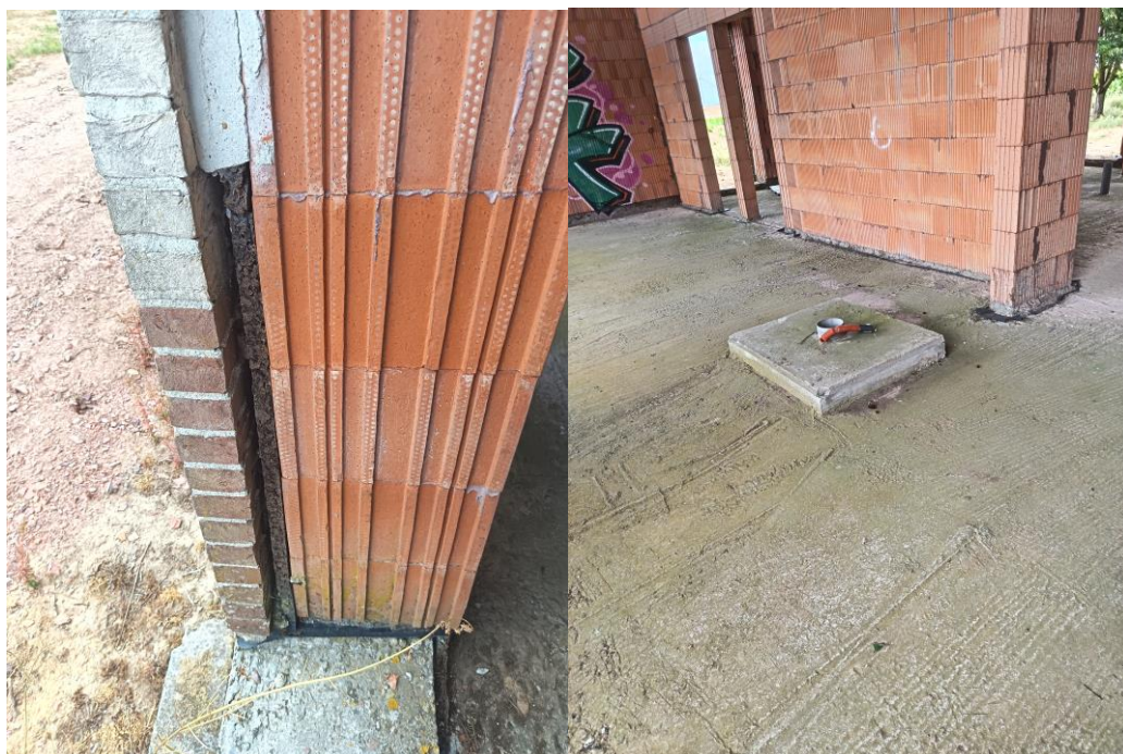
Isolation en liège et puits canadien, Source : visite de terrain VERDI
