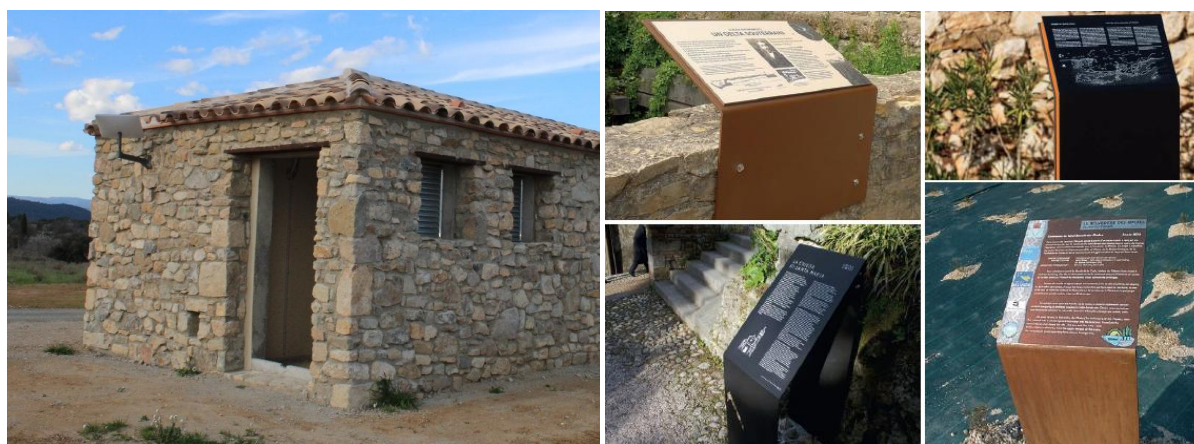
Figure 27 : Poste de transformation avec bardage en pierre locale et panneaux pédagogiques d'information (Source : Sun'Agri, novembre 2024)
