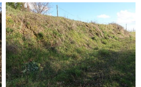
Talus au niveau du lieu-dit « Lasbouères » Source : ARTIFEX 03/2023
