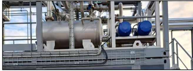
Illustration 4: Vue des pompes à vide et de leur emplacement au sein de l'unité © EODD, 11/12/2024
