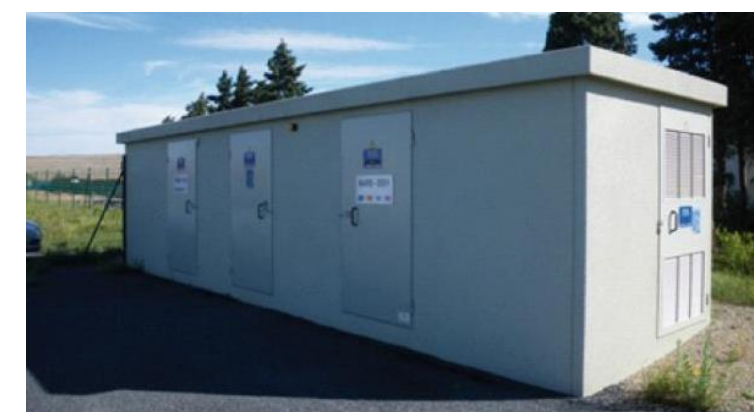
Photographie 5 : Exemple de poste de livraison (Source : ENCIS Environnement)
