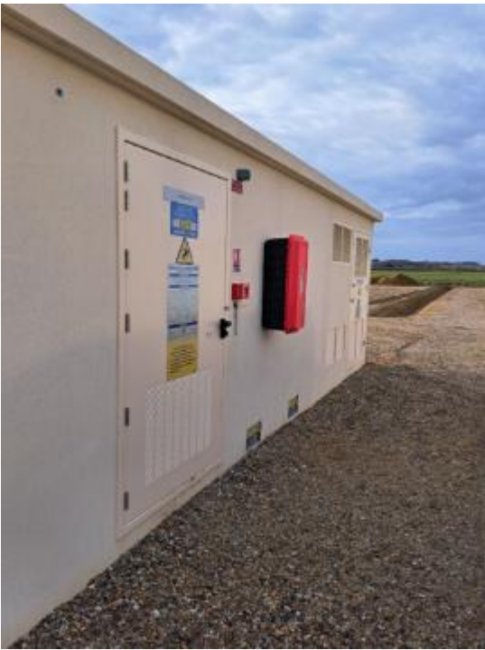
Photographie 3 - Vue réelle d’un poste combiné de transformation et de livraison (source : REDEN)
