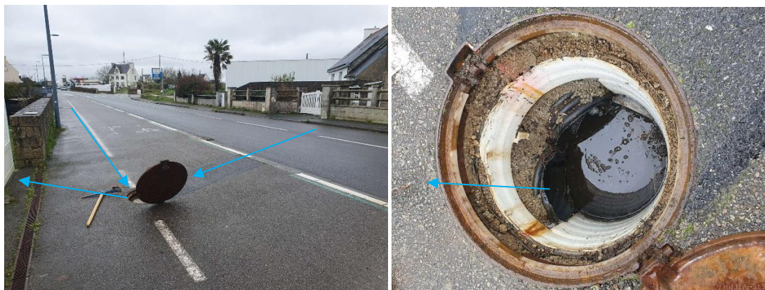
Figure 5 : Regard EP rue de la République
