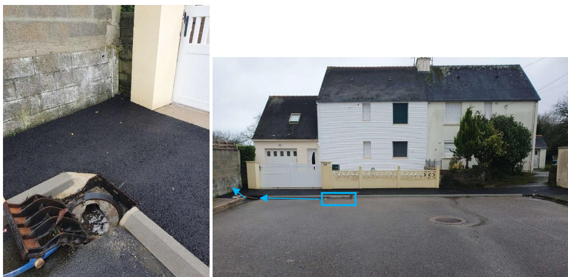
Figure 7 : Ouvrage et trop-plein impasse Jules Ferry (02/02/26)
