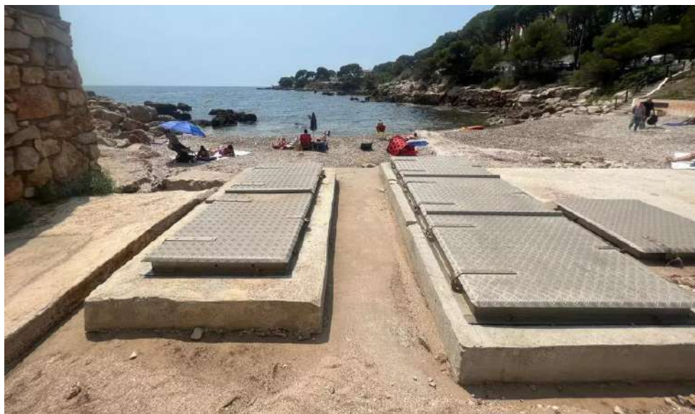
Figure 59. Station de relevage des eaux usées située sur la plage Eden Roc– Nice-Matin
