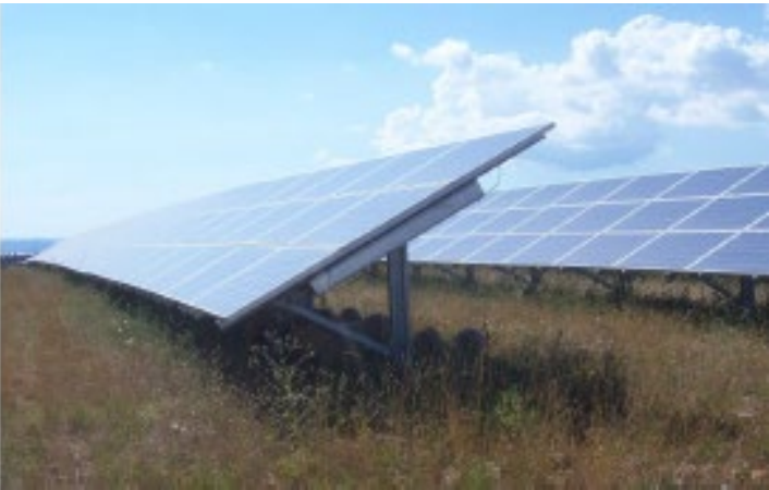
Figure 7 : Module photovoltaïque fixe. Source : Enoé
