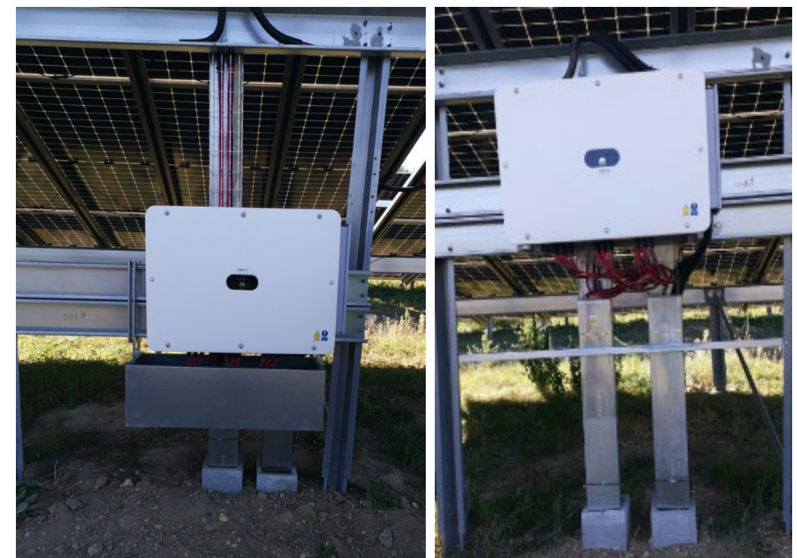
Figure 10 : Onduleurs. Source : Enoé
