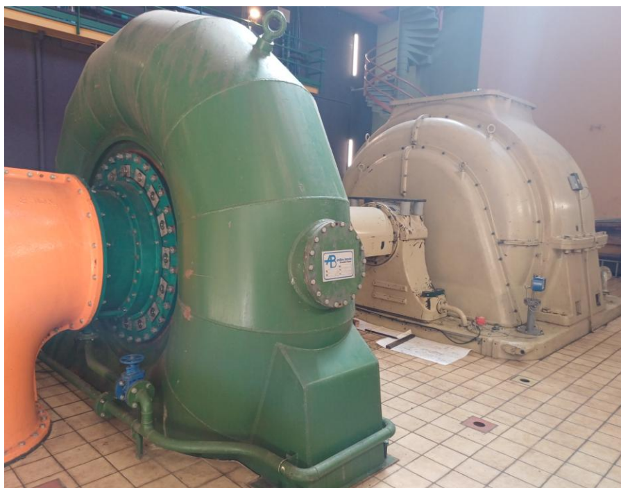
Groupe N°1 de la centrale d'Eygliers
