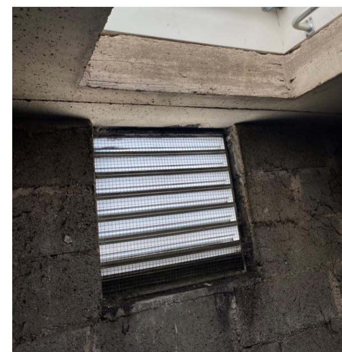
Grille avec accès depuis l'extérieur
