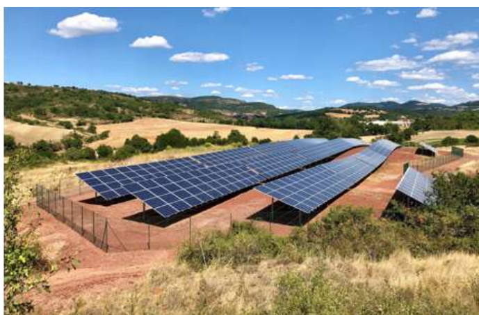
Exemple de structures fixes (Parc solaire de 249 kWc à Lagarde à Camares dans l'Aveyron (12) d'Enercoop Midi-Pyrénées sur une ancienne décharge
