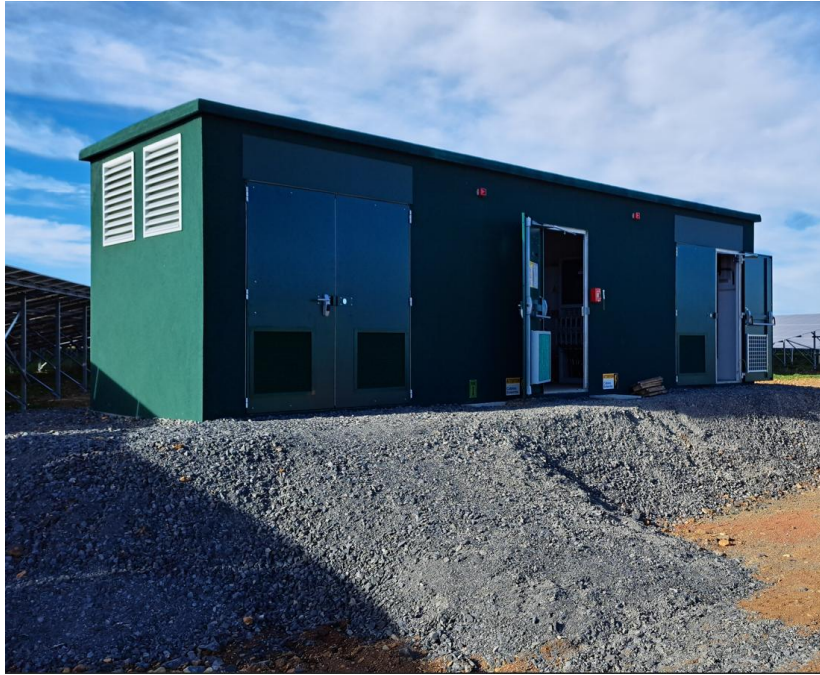
FIGURE 3. EXEMPLE DE POSTE DE TRANSFORMATION AVEC TALUS
