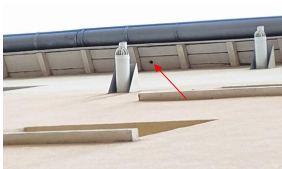
Trou dans le dessous de la toiture en bois d'un immeuble permettant potentiellement aux chiroptères d'accéder à un espace favorable pour gîter (©Biotope).
