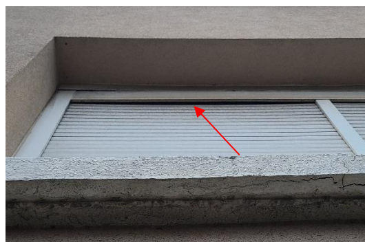
Interstice localisé au niveau d'un volet roulant d'un immeuble et qui pourrait être potentiellement suffisant pour qu'un ou quelques individus puissent venir s'y glisser et gîter (pipistrelles notamment) (©Biotope).
