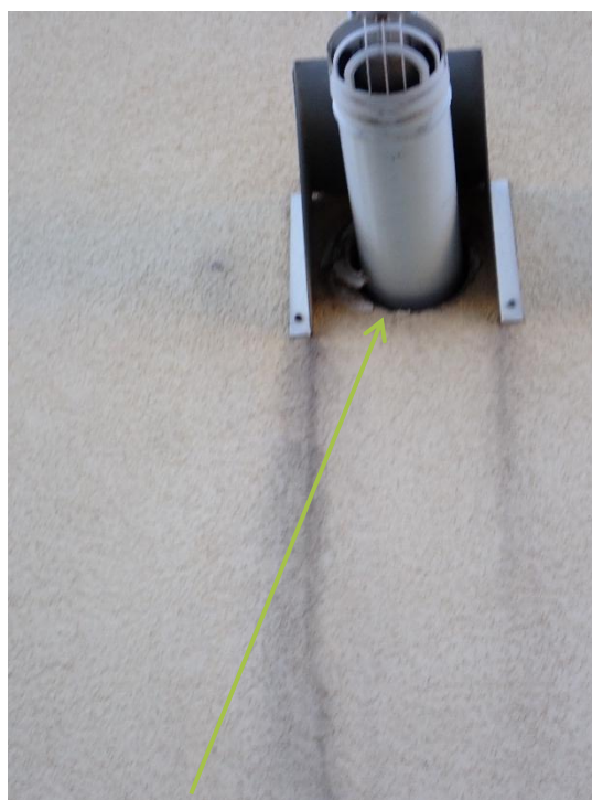
Joints défectueux et gites utilisés
