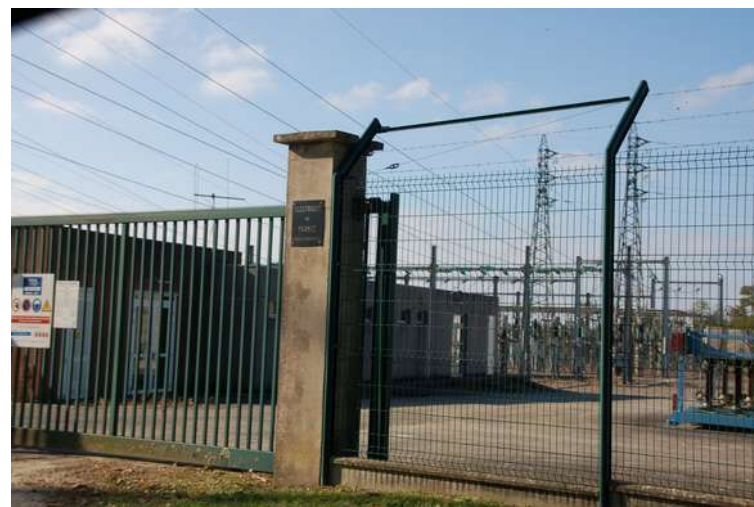
Poste source de Concarneau, à 300m à l'est du terrain
