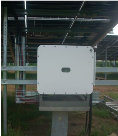
Figure 2: Chemin de câble jusqu'à l'onduleur
