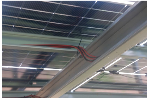
Figure 3: Les câbles du module rejoignent un chemin de câbles aérien
