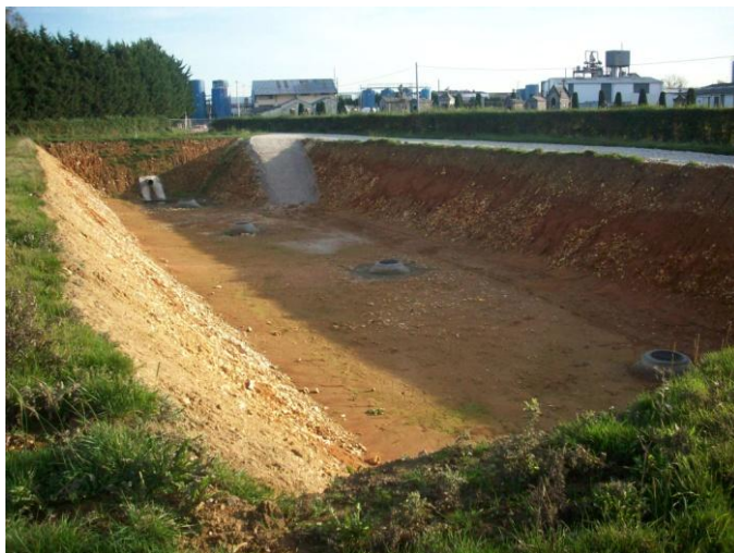
Figure 28. Exemple de bassin d'infiltration réalisé par Verdi Ingénierie Seine
