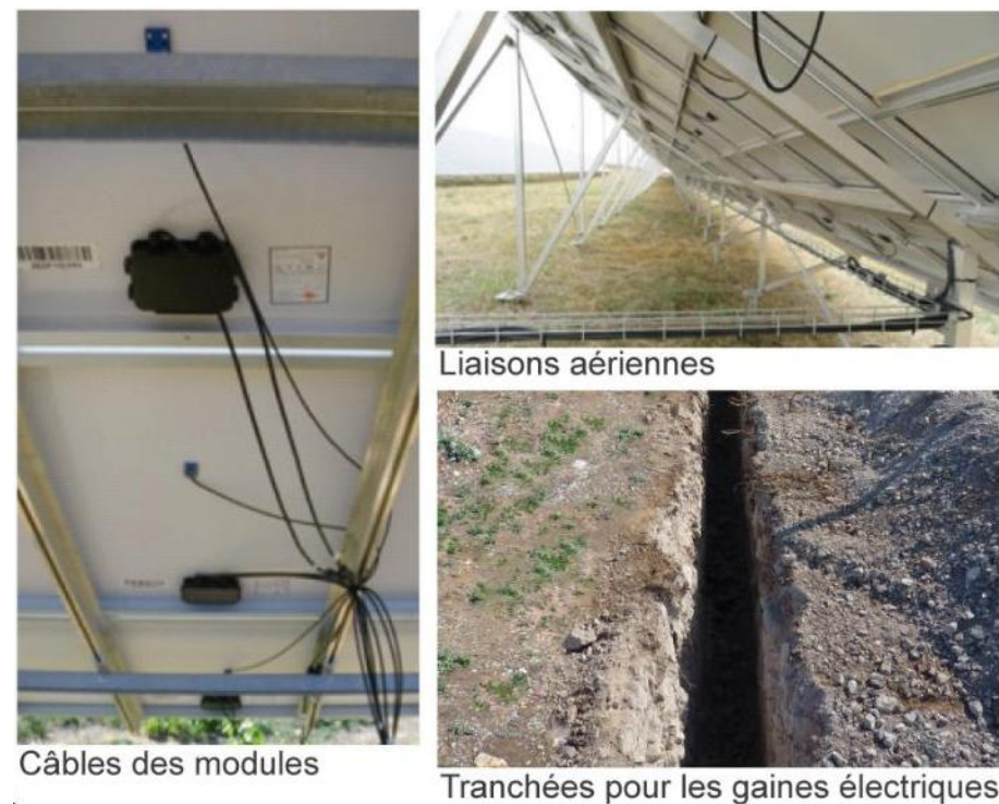
Photographie 5 : Liaisons électriques (Source : ENCIS Environnement)
