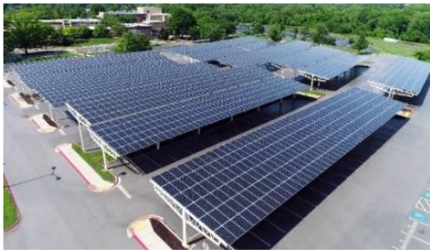
Centrales solaires en ombrières
