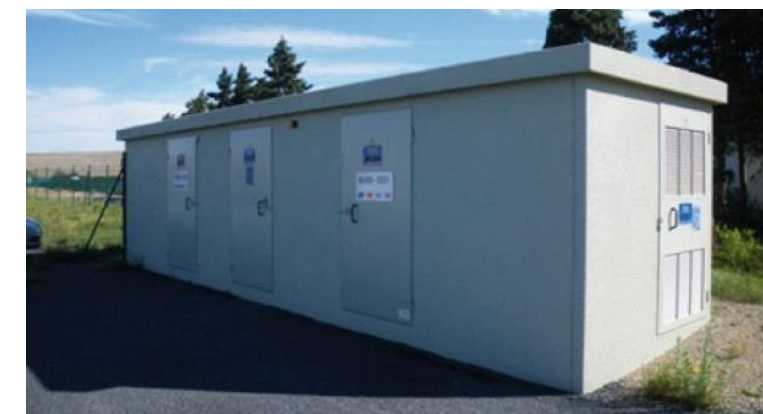
Photographie 4 : Poste de livraison (Source : ENCIS Environnement)
