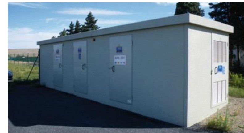
Photographie 4 : Poste de livraison (Source : ENCIS Environnement)
