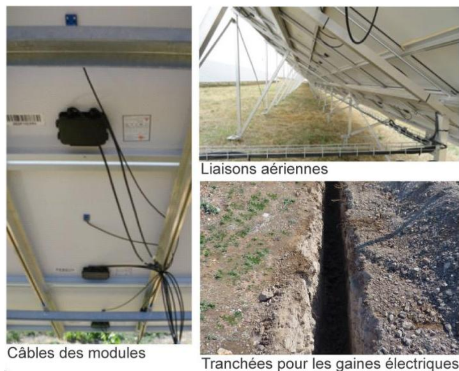
Photographie 5 : Liaisons électriques (Source : ENCIS Environnement)
