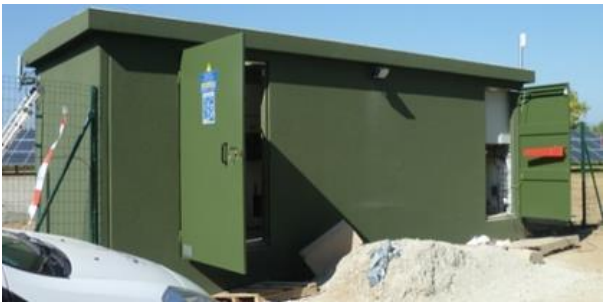
Figure 5 : Exemple de poste de livraison
