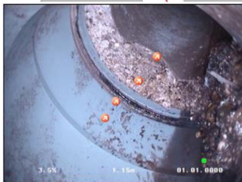
Photo: 25_25_71_A.JPG 1,1m, Inspection abandonnée, coude vers la droite trop prononcé
