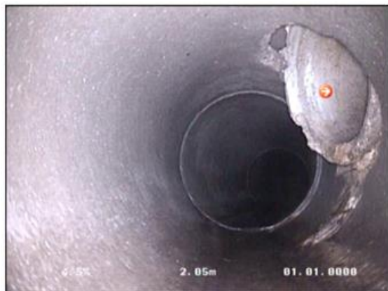
Photo: 24_24_54_A.JPG 2,8m, Selle, carottée, raccordement ouvert à 3 h., hauteur: 150 mm, (largeur: 150 mm)
