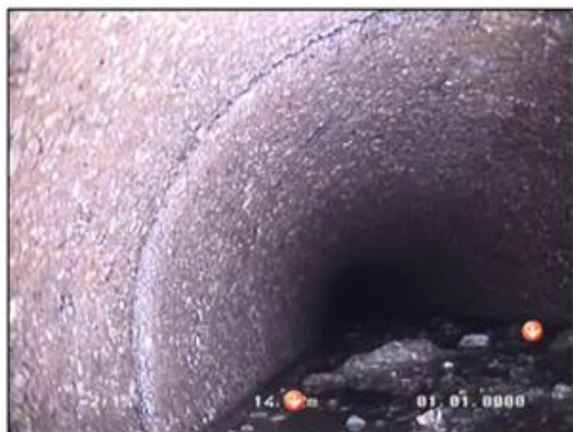
Photo: 32_32_92_A.jpg 14,9m, Dépôts de matériau fin (sable, vase) sur le radier de 4 à 8 h. épaisseur des dépôts: 20 %
