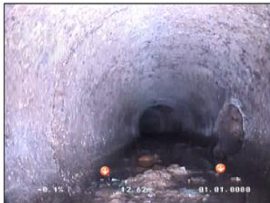
Photo: 33_33_97_A.jpg 12,8m, Dépôts de matériau fin (sable, vase) sur le radier de 4 à 8 h. épaisseur des dépôts: 20 %
