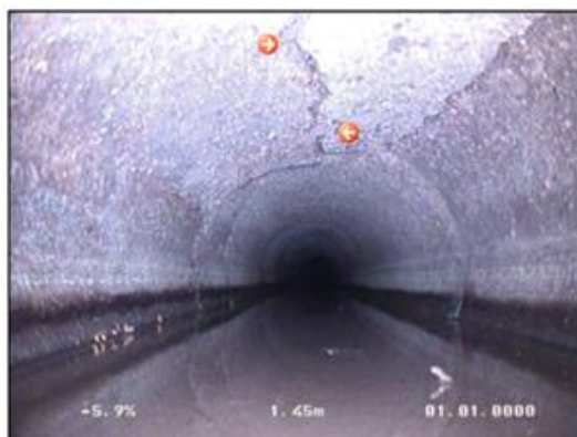
Photo: 33_33_94_A.jpg 1,5m, Fissure fermée, longitudinale à 12 h., largeur de la fissure: 4 mm
