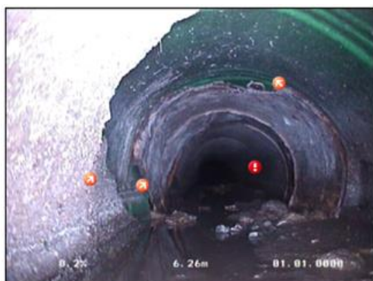
Photo: 33_33_95_A.jpg 6,6m, Une reprise bouchant un trou pratiqué dans la paroi est devenu défectueuse
