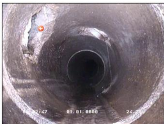
Photo: 24_24_57_A.JPG 25,2m, Selle, carottée, raccordement ouvert à 9 h., hauteur: 125 mm, (largeur: 125 mm)
