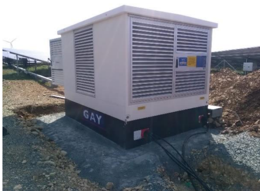
Figure 14 : Exemple de poste de transformation (Source : Charles Chevalier)
