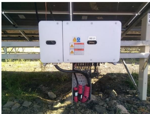
Figure 20 : Raccordement des câbles aux onduleurs (Source : Charles Chevalier)
