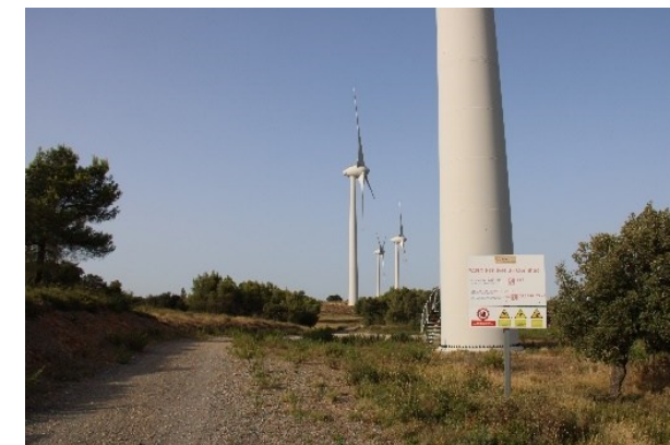
Parc éolien de Conilhac Source : ARTIFEX 2021
