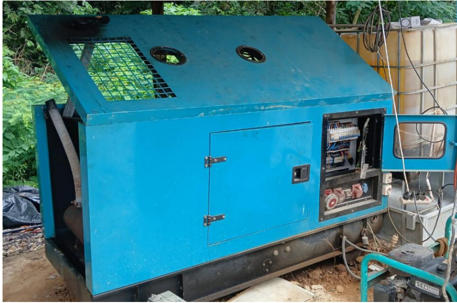
Figure 10 : Groupe électrogène utilisé pour l'alimentation en énergie de la base-vie.
