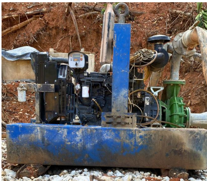
Figure 4 : Motopompe utilisée pour le pompage de l'eau de process dans le circuit fermé de décantation.
