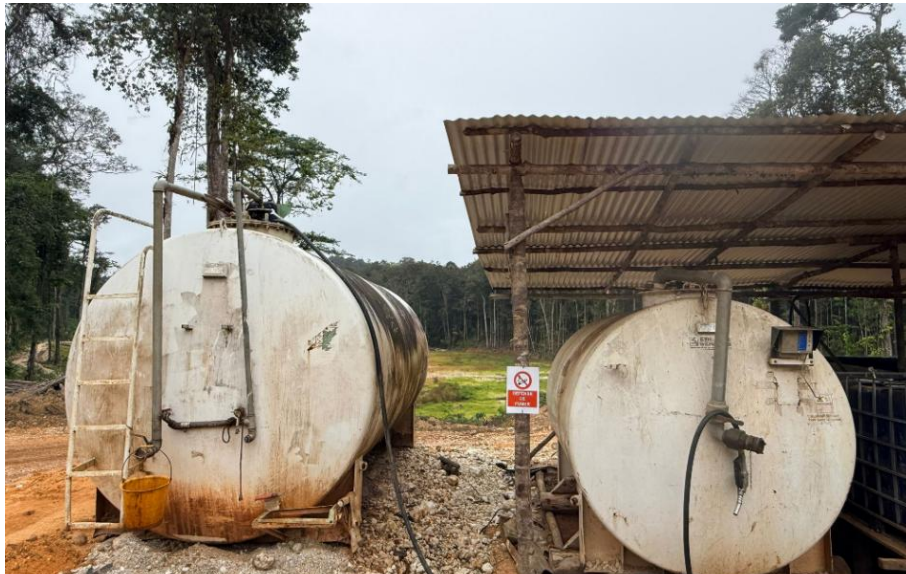
Figure 9 : Citerne double parois utilisées pour le stockage du carburant.
