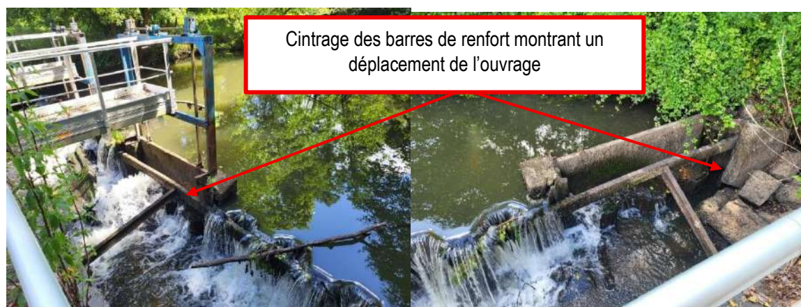
Figure 2 : Photographies de l'ouvrage Palplanche montrant une dégradation
