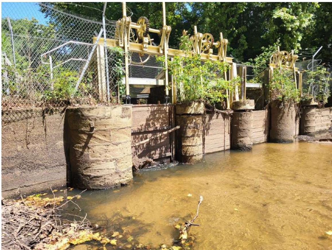
Figure 3 : Photographie montrant la dégradation de l'ouvrage Vauban
