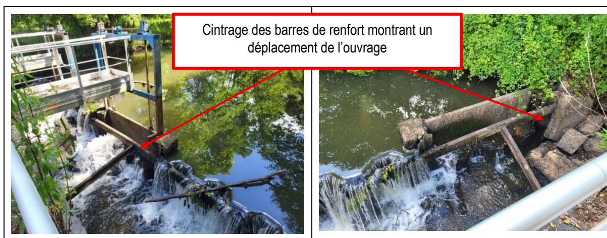
Figure 5 : Photographies de l'ouvrage Palplanche montrant une dégradation
