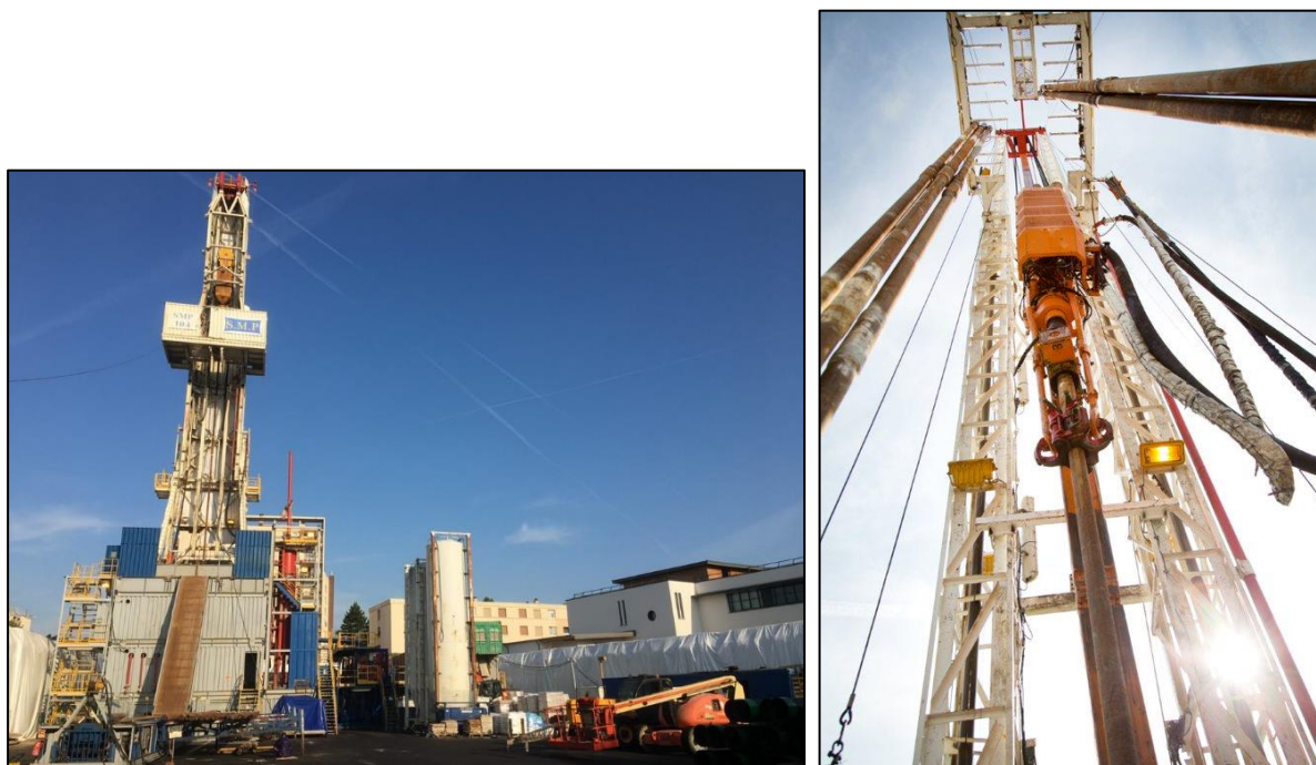
Figure 13 – Exemples d’ateliers de forages géothermiques
