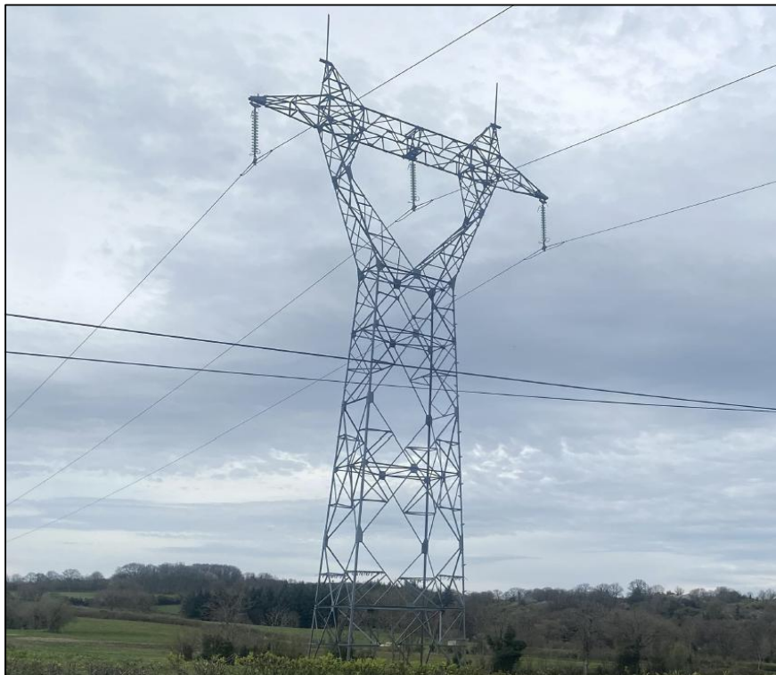
Illustration 13 : Pylône à 225 000 volts sur la commune de Treignat
