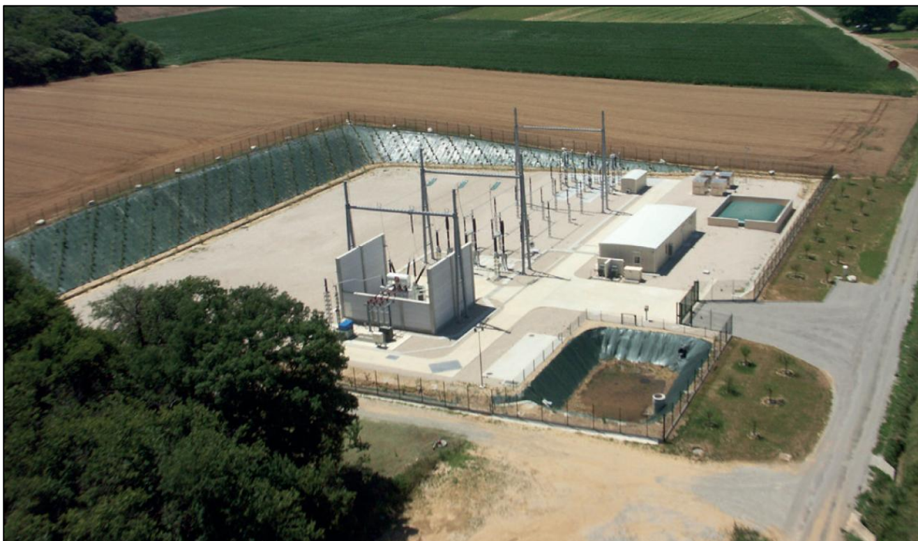
Illustration 8 : Exemple de poste électrique à l'air libre 225 000/20 000 volts
