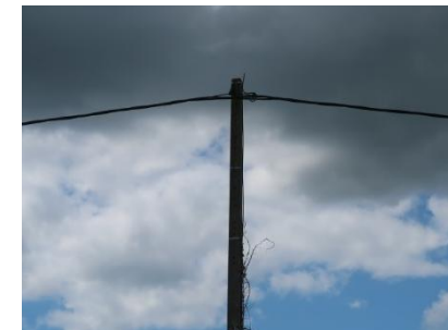
Ligne électrique aérienne Source : ARTIFEX 05/2022
