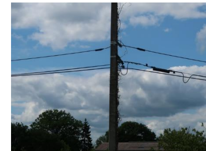
Ligne de télécommunication aérienne Source : ARTIFEX 05/2022
