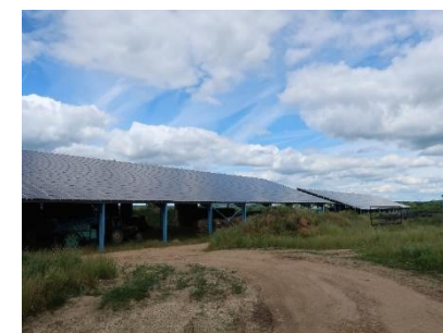
Bâtiments agricoles avec une toiture photovoltaïque
