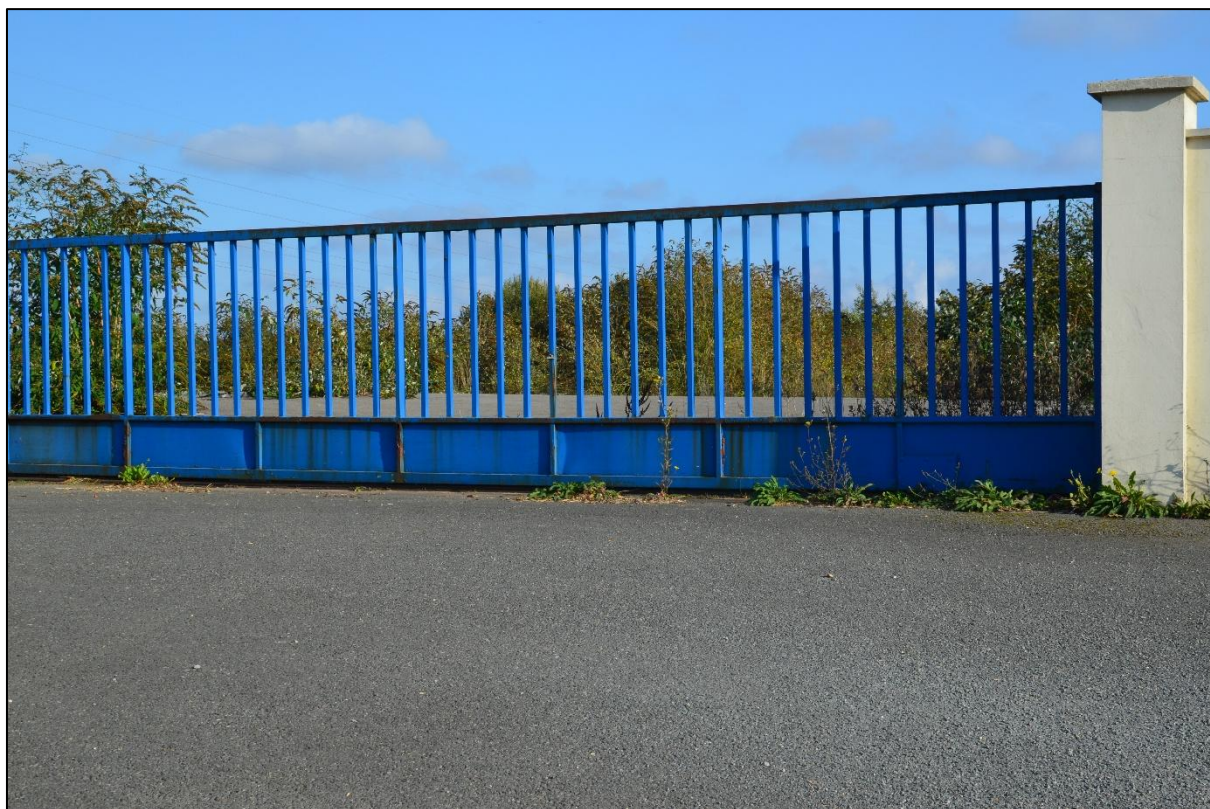
Prise de vue n°1 (source : KDE ENERGY France)
